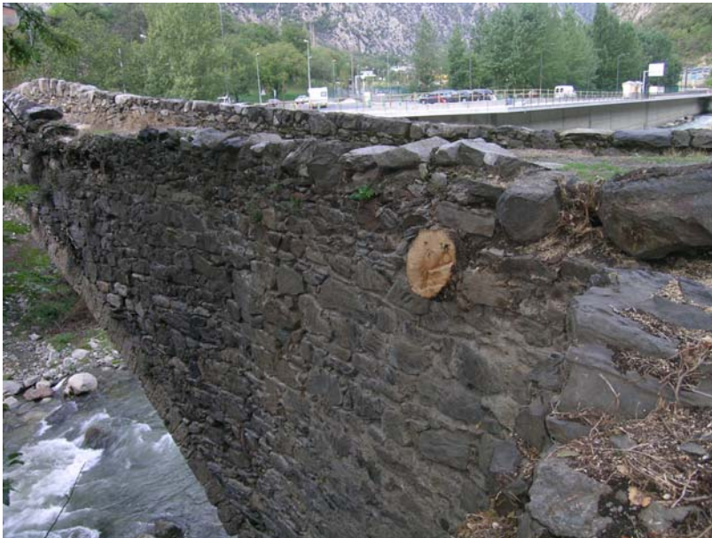
20 i 21. Exemple de fissures en els carcanyols de l'arc.
