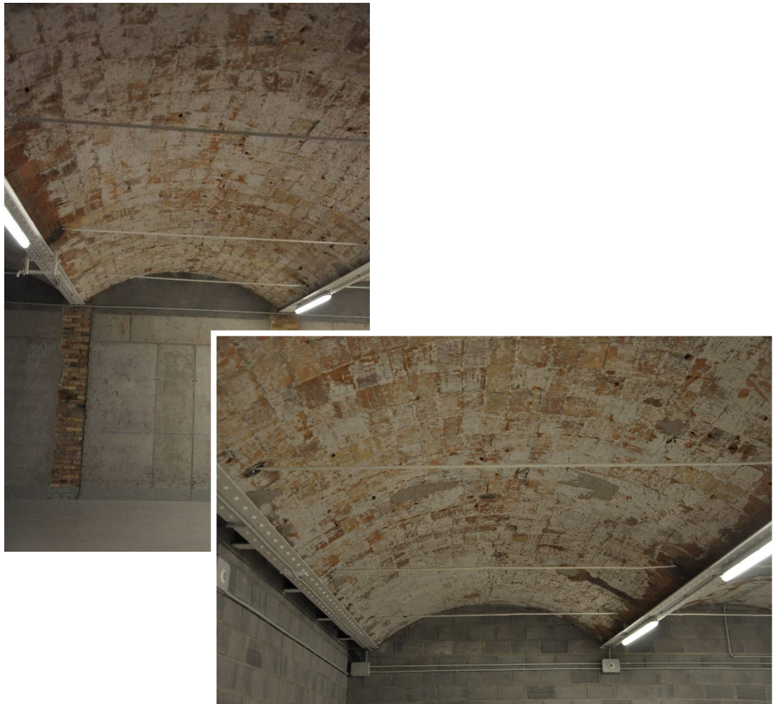
Voltes del garatge de l'hotel Rosaleda després de la restauració (E. Dilmé, X. Orteu, J. Vidal, 2020). Podem veure la part inferior de les bigues amb les seus característics botons per unir les peces així com els tirants de tracció entre voltes a la catalana (E. Dilmé, 2020).
